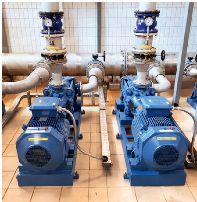
Reinwasserpumpen im Wasserwerk Düşhorn
