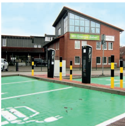
Umgezogen auf den großen Parkplatz an der Poststraße: die Ladestationen der Stadtwerke
